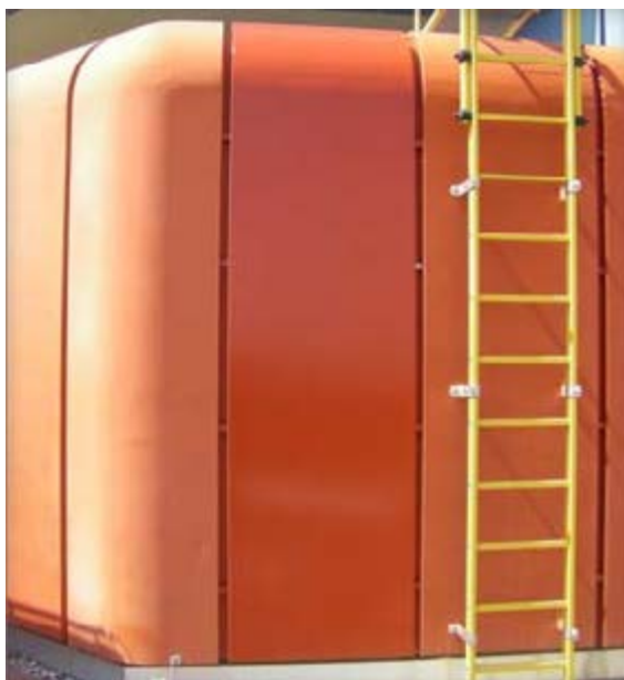
Bild 20: Metallfassade pulverbeschichtet, 15 Jahre nicht gereinigt mit Reinigungsmusterfläche
